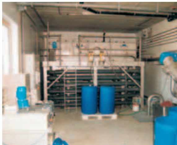
Slaughterhouse Ingolstadt / Germany:
